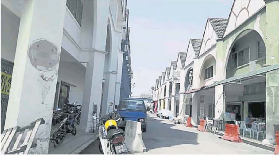
墙壁上的禁止驶入告示牌已模糊不清。
